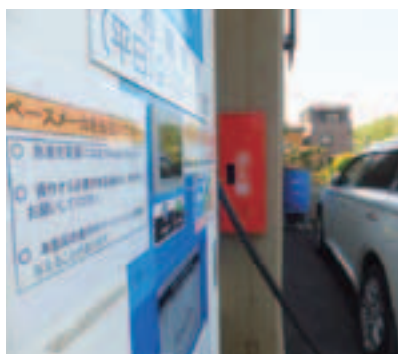
市役所前の急速充電器に改めて掲示した注意喚起のシール
