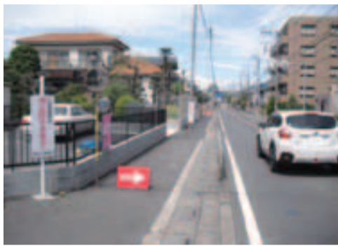
■新座駅北口土地区画整理事業によって歩道幅が進む県道新座・和光線
