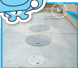
浄化槽のマンホール部分
