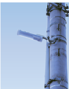
▲LED化した道路照明灯
