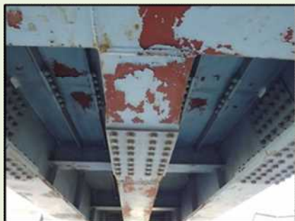
塗装の劣化状況
