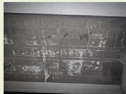
ひびわれ状況
