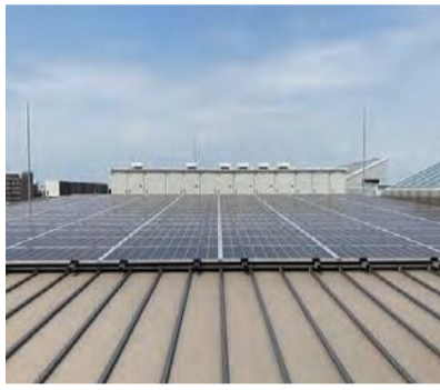
市役所本庁舎に設置されたソーラーパネル
