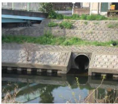
河床の上昇により川面が排水口に迫っている黒目川
