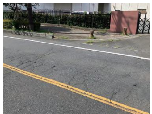
市道第1号線の舗装が傷んだ箇所
