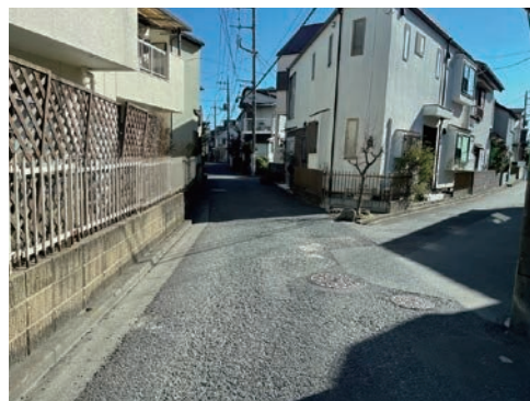
■路面が傷んでいる市道第7296号線
