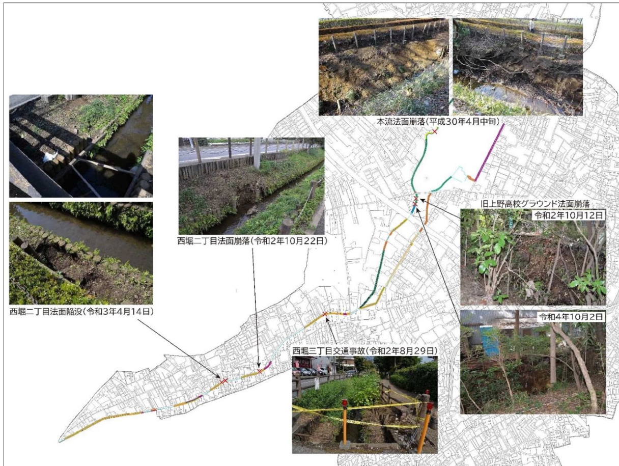
図 48：崩落危険箇所と近年のき損箇所
