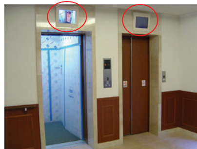
写真Ⅱ.64 エレベーターホールに設置されたエレベーターかご内の様子を把握できるモニター
