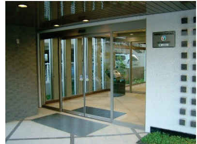
写真Ⅱ.58 注1) オートロック式の自動エントランスドア
