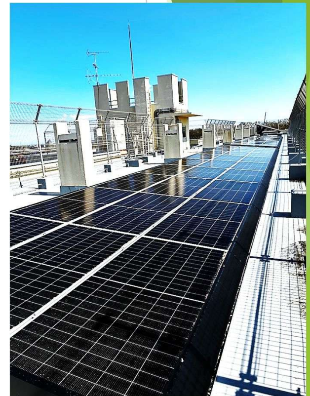
↑ 新堀小学校に設置した太陽光発電設備
