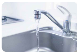
蛇口の水漏れ
