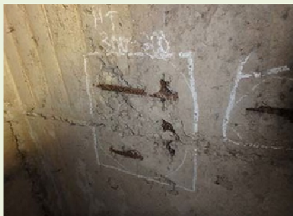
塗装の劣化状況
