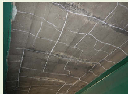
ひびわれ状況
