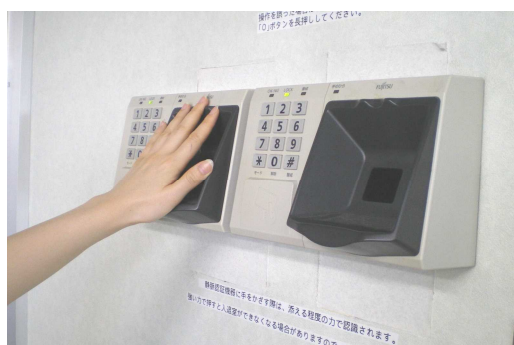
静脈認証による入退室管理の例 (現本庁舎サーバ室)
