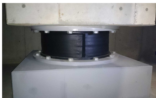
免震装置設置の例 (愛知県刈谷市)
