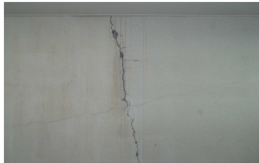
庁舎内壁クラック跡
