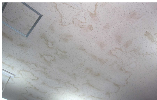
天井の雨漏りの跡
