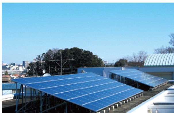
太陽光発電設備の例 (新座市立大和田小学校)
